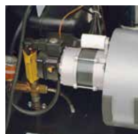
En-faset motor koblet til vifte og dieselpumpe.
